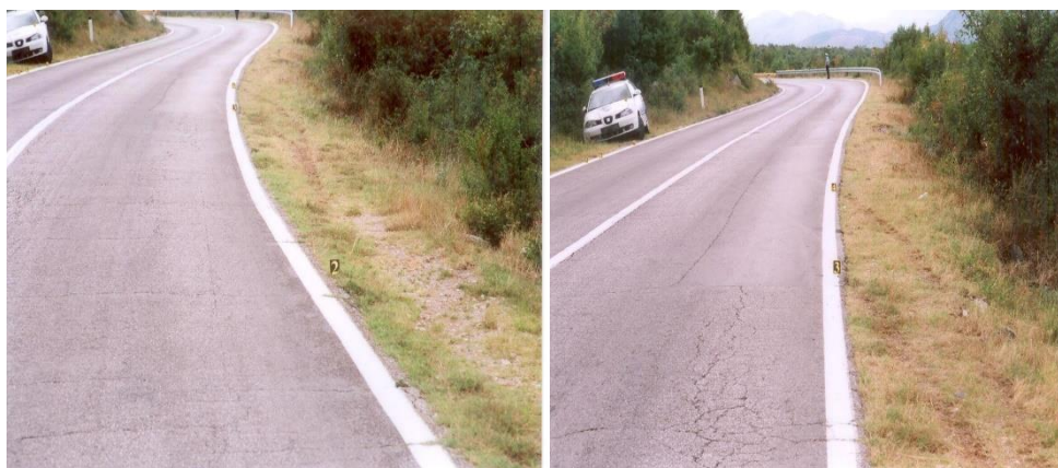
Slika 2. Tragovi destabilizacije (početak i zvršetak) na desnoj bankini
